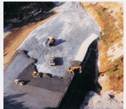
180.000 m 3 Schüttmaterial wurden in nur zwei Monaten eingebaut! (Fotos: M. Scheibner, ILF)
